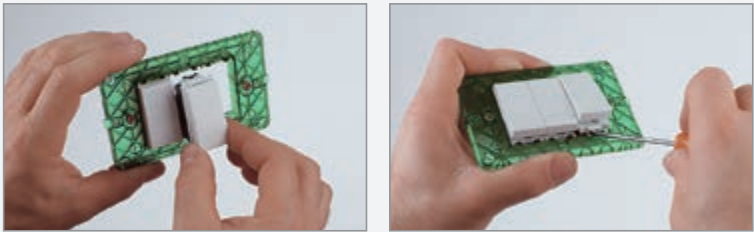
Montare aparataj Montare aparataj
